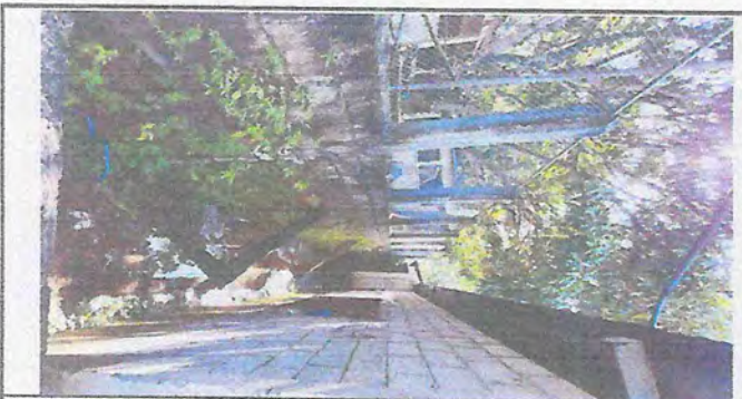
Foto 5: Pared Perimetral en mal estado.
