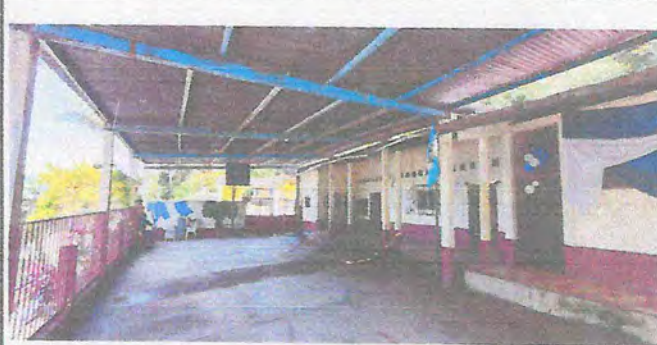
Foto 2: Techo de Cancha separado del techo del corredor.
