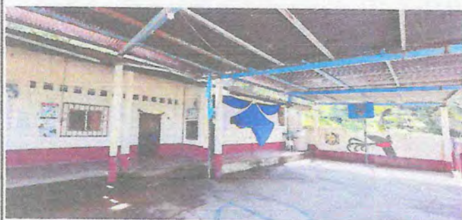
Foto 1: Estructura de Techo deteriorada. Laminas oxidadas y rotas por tiempo.
